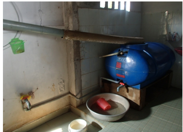
雨水貯水タンク(ホーチミン市 9 区)
