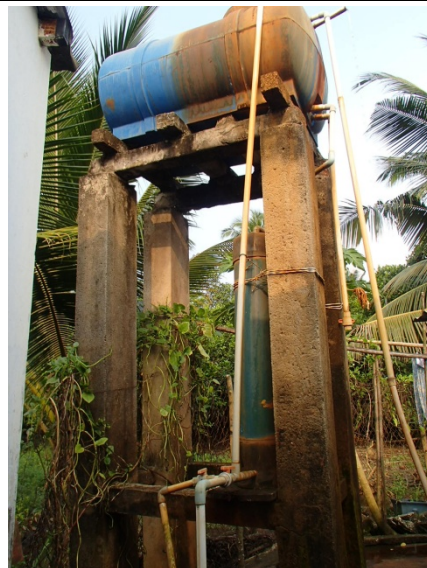
鉄の付着した井戸水貯水タンク
