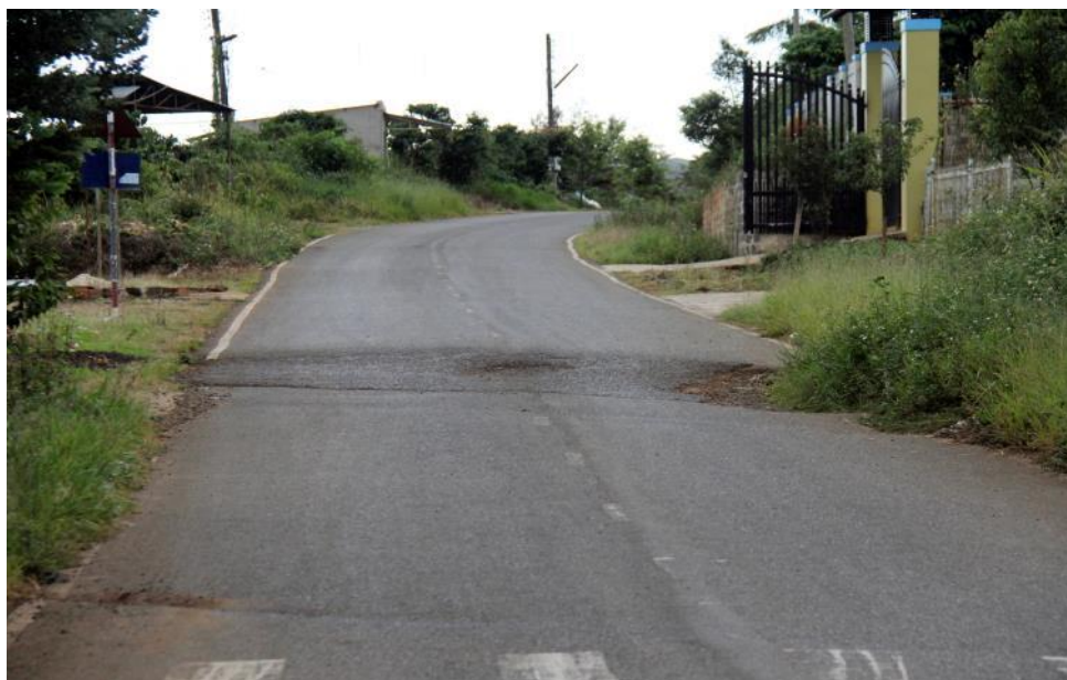
図 5-8 道路面に出現した段差を伴う地すべり頭部域に出現した大規模亀裂
