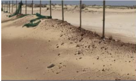
<写真27:剥がれたフェンス>
