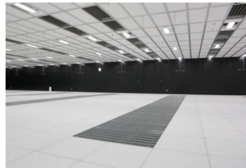
ダブルデッキシステム (コンピュータエリア)
