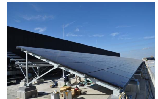
太陽光パネル
