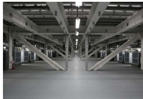
ダブルデッキシステム (メンテナンスエリア)
