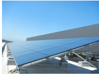
太陽光発電システム
